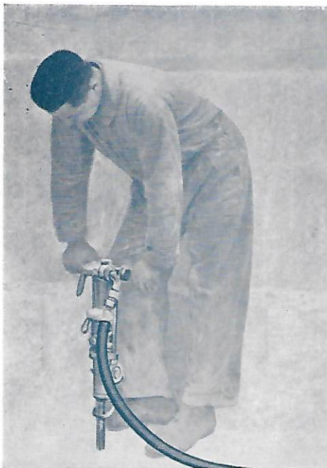
Fig. 25. — Alimentation en air comprimé de perforatrices de carrières.
