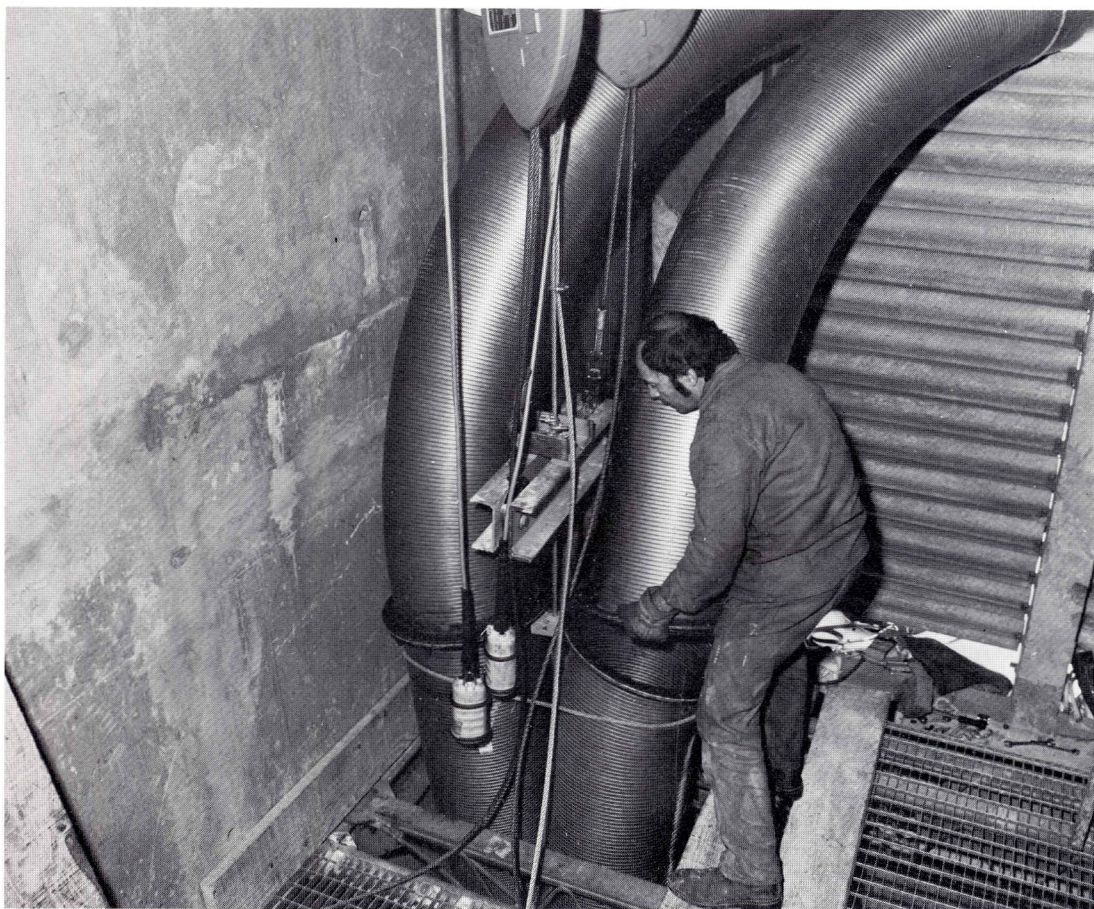
Caserne des Sapeurs Pompiers de Paris. Deux tuyaux de tubage gros diamètre (400 mm) installés côte à côte. Raccordement des différentes longueurs par brides.
